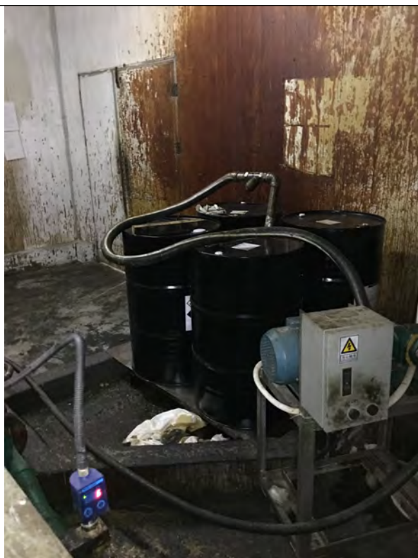
发泡料中转储罐区
