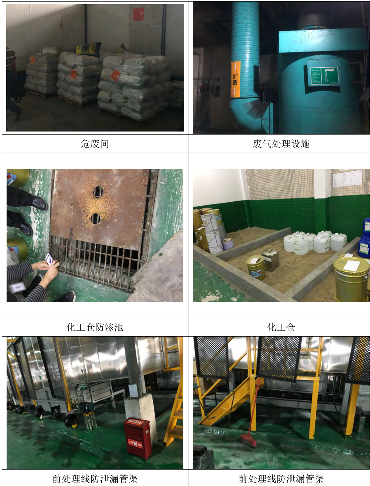
图 2.7-1 现有工程主要环保措施照片
